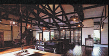
4 既存間戸梁を工事中に急遽一段高くして掘り炬燵風にアレンジ
